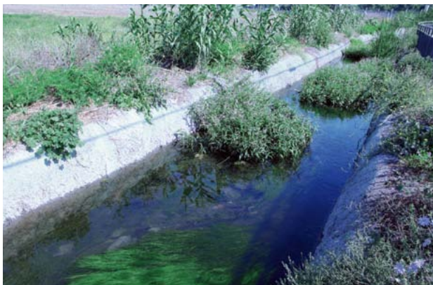
Foto 1. Canal de regadío con malezas.
